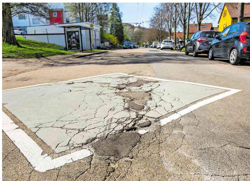
Ein einziger Flickenteppich: Die Mutzenreisstraße auf dem Esslinger Zollberg wartet seit Jahren auf ihre Sanierung. Foto: Roberto Bulgrin
